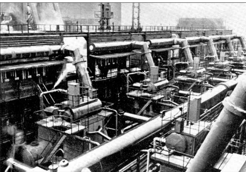
Instalacja gazu pokrakingowego
