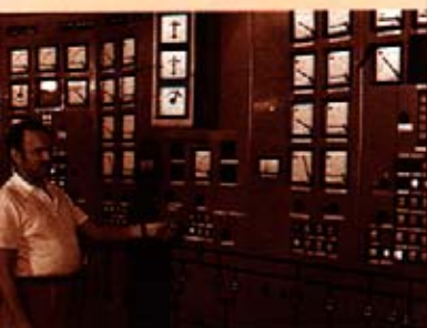
Nastawnia ruchu elektrycznego, tzw. PG, 1970 r.
