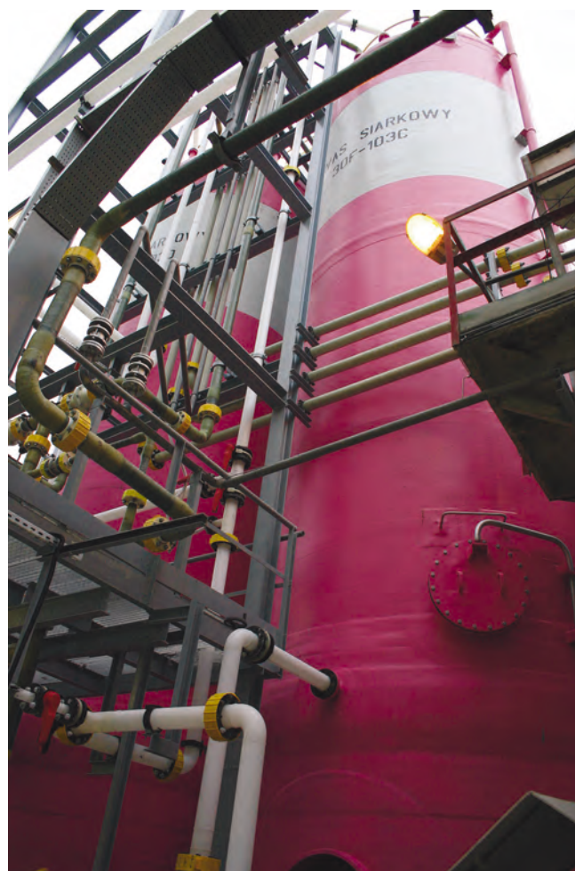
Siarczan amonu – instalacja
