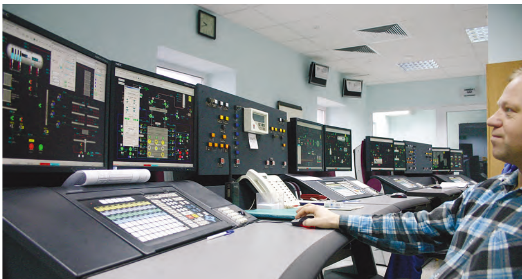
Elektrociepłownia II, 2006 r.
