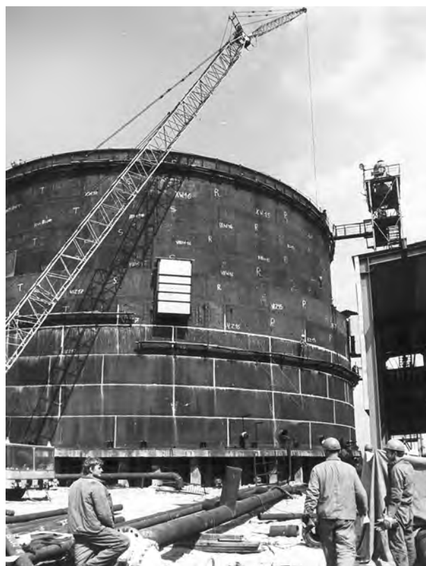
3 grudnia 1982 r. oddano do użytku beciśnieniowy zbiornik amoniaku
