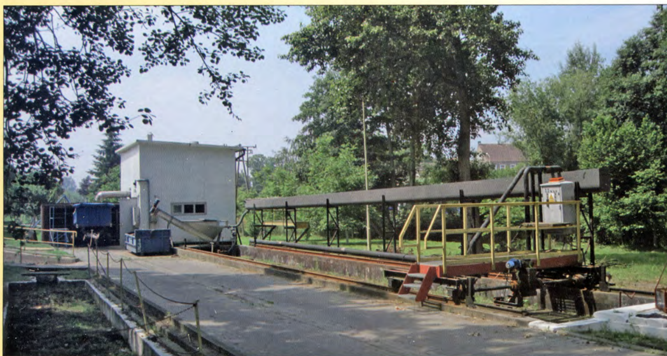
Piaskownik oraz urządzenie do usuwania „skratek” (w tylnej części zdjęcia) w Przepompowni Głównej Ścieków przy ul. Dębowej
